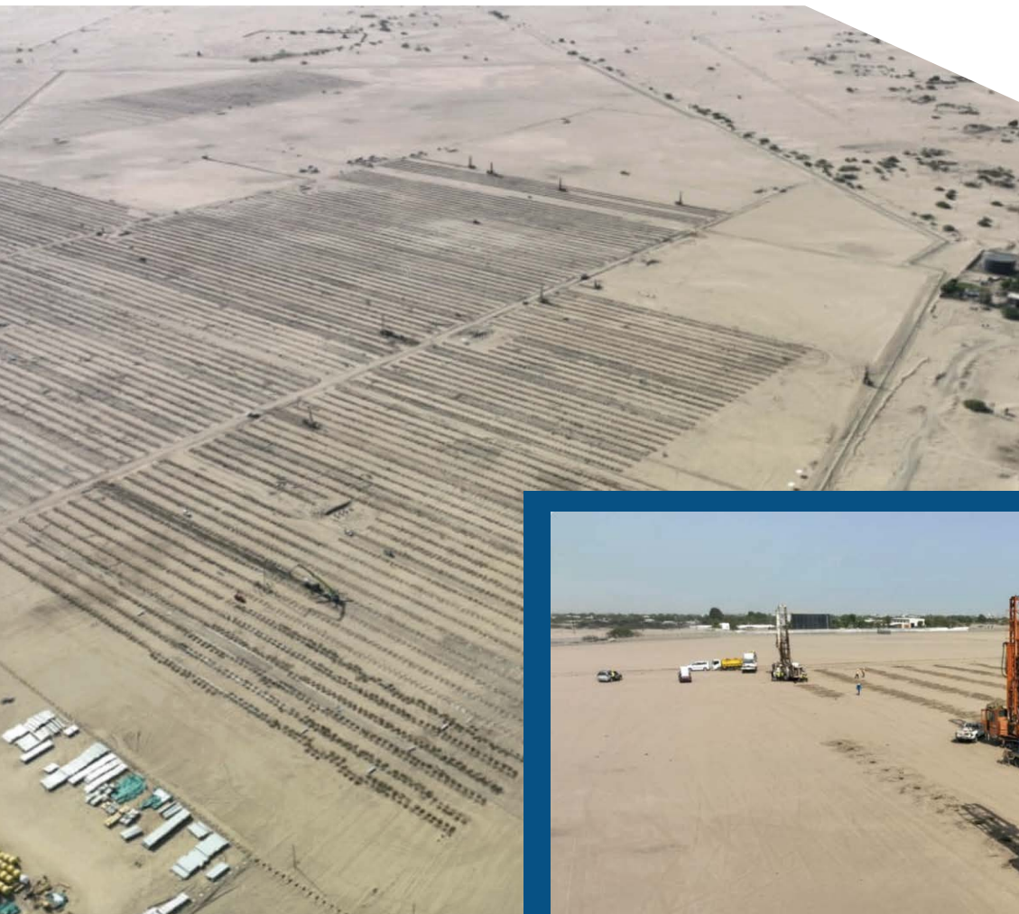
120MW ADEN SOLAR PROJECT
